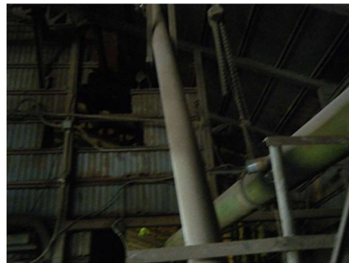
搬送用ダクト
